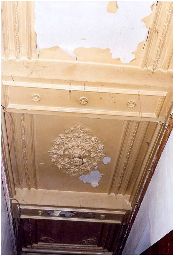
Afb. 10. Stucplafond in de gang, voor restauratie
