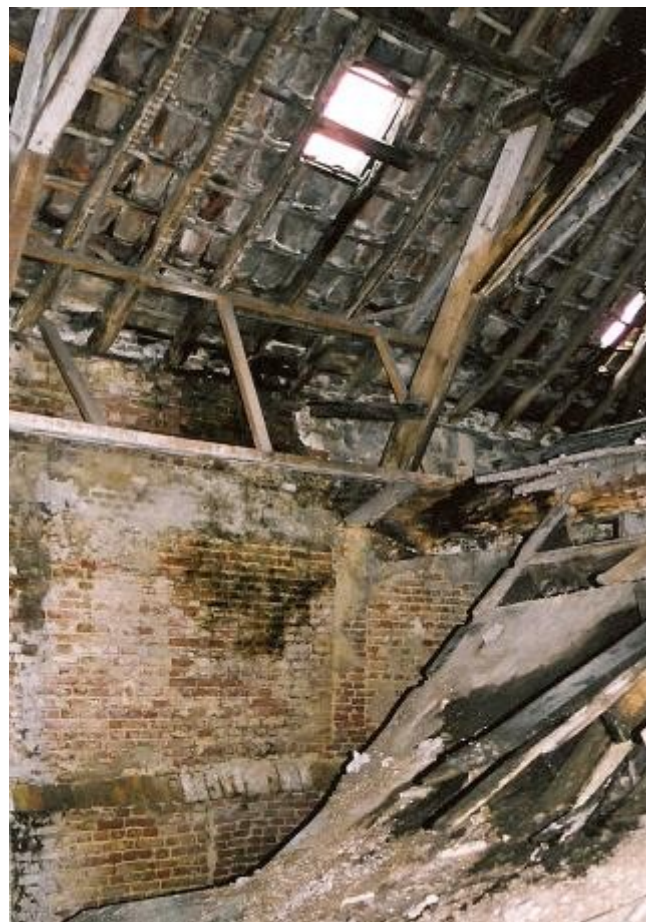
Afb.23. Instorting van de zolderbalklaag. In de muur is nog goed de moet zichtbaar waar oorspronkelijk het spantbeen geplaatst was. Zichtbaar is ook de versnijding van de muur t.p.v. de oorspronkelijke zoldervloer.
